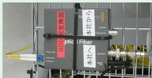
写真2:スタジオ側に設置した光伝送装置
