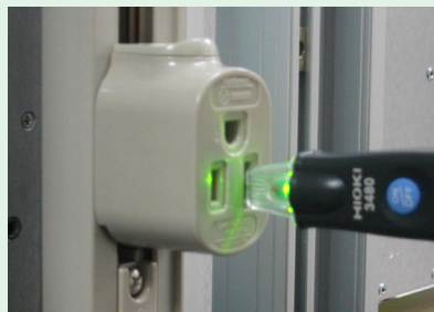
写真2: コールド側を示す検電器
