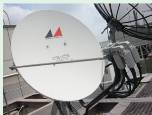
写真1:アンテナ全景
