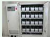
写真5: バッテリー(扉を開けた様子)
