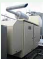
写真1: 屋外発電機の外観
