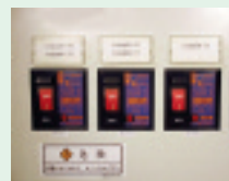
写真4: ブレーカ外観
